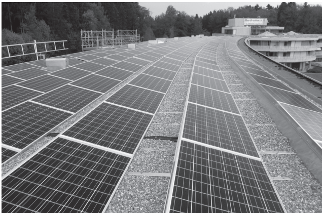
Photovoltaikanlage auf dem Dach der Rotonda
